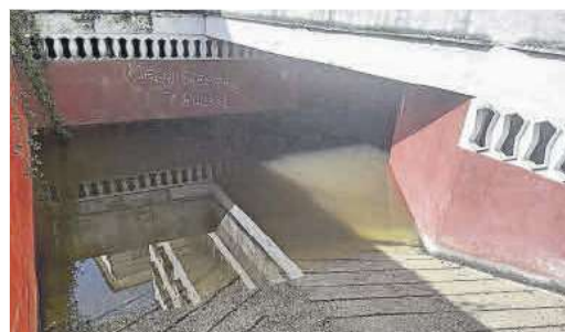
Inundaciones del parking Noria 4.
