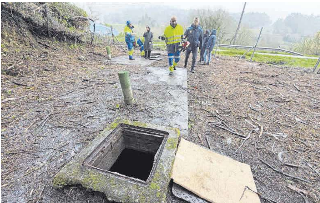
Captación del lavadero de A Regueira, que se contaminó de hidrocarburos.
